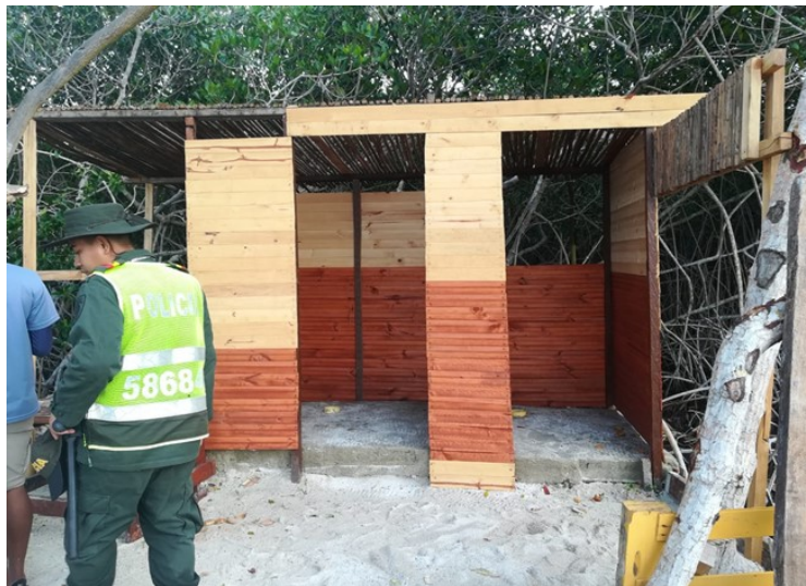
Foto 10 "Baños" con piso en concreto, tubo de PVC al centro. Paredes en madera. Techo con varas de "lata" en coordenadas geográficas 75^{\circ}40'32,5''W 10^{\circ}08'22.6''N
