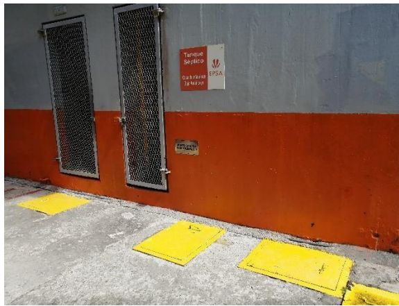
Foto 1. Tanque Séptico Instalaciones operativas
