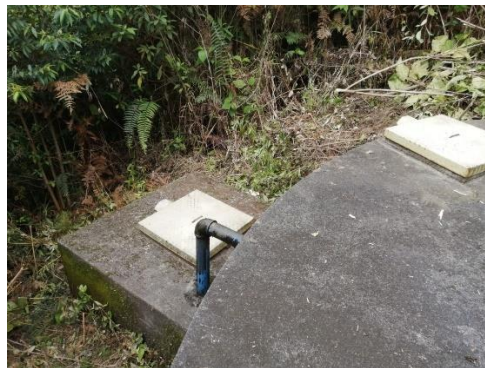
Foto 4. Tanque de Almacenamiento
