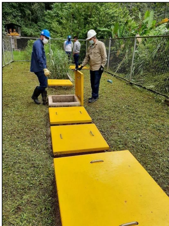
Foto 1. Sistema Séptico Campamento Yatacué
