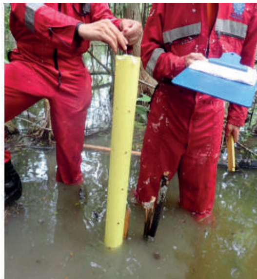
B: Instalación de los sensores para medición del hidro período en el sector de calo Clarín Nuevo
